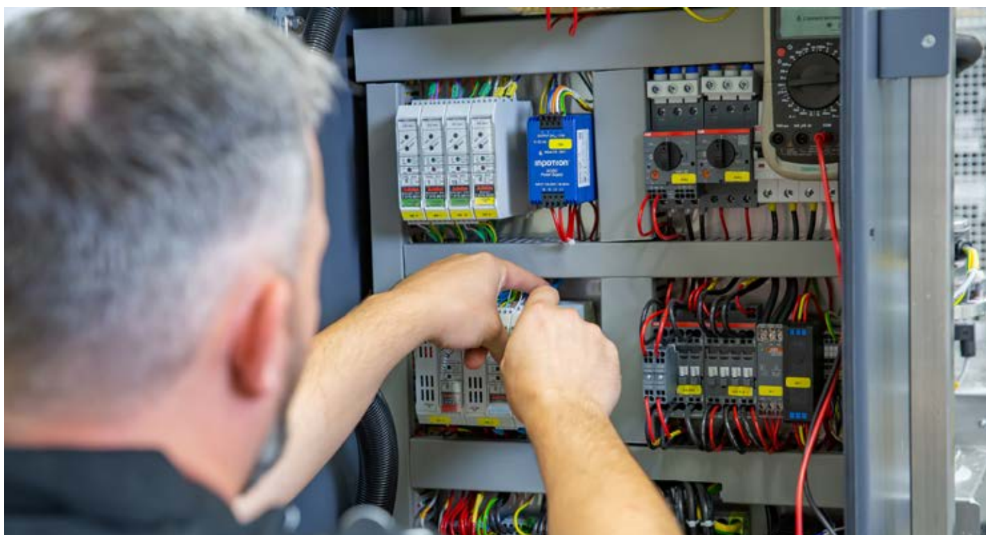
L'électronique de commande est une condition préalable importante pour une grande cohérence dans les applications de thermostatisation.
